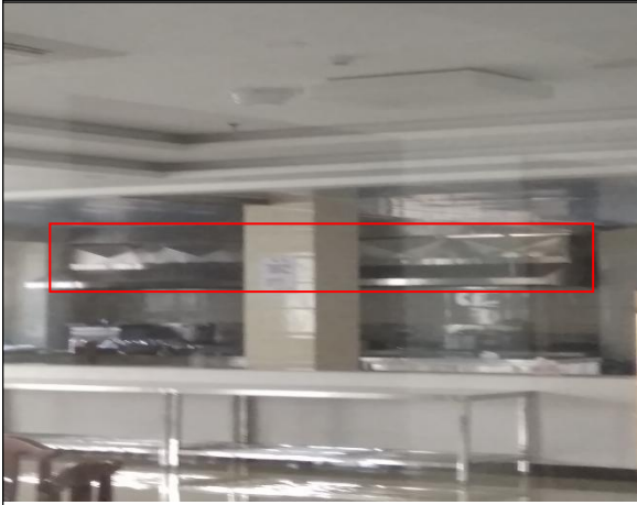
厨房油烟净化系统
