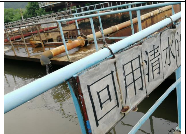
污水处理站回用水池
