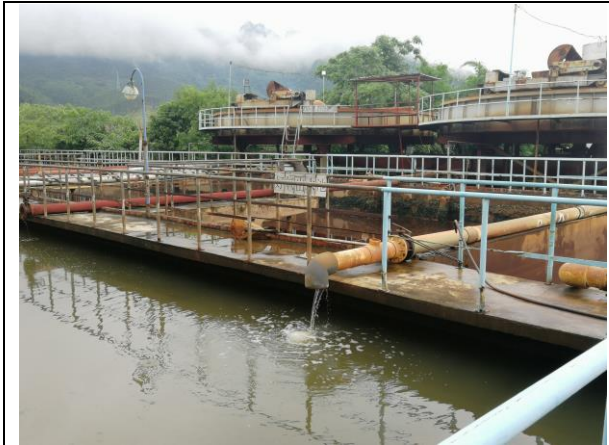
厂区污水处理站
